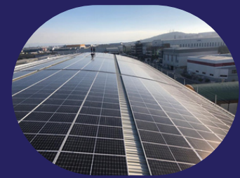
KBS Kalıp 1092 kWp
